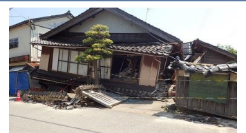
珠洲市正院町正院の被害状況
