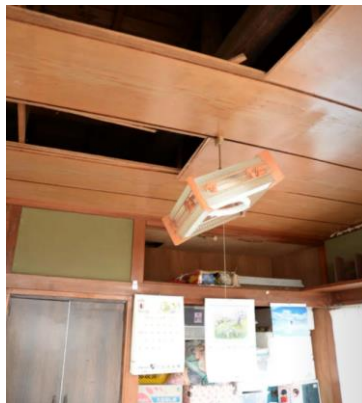
10年経過しても未修理の住宅
