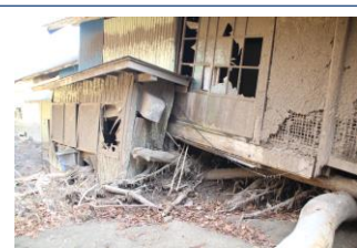
土砂崩れで全壊した住家
