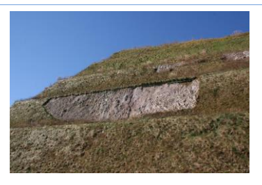
法面は部分的に崩壊。多数の落石があり通行も危険。写真反対側の斜面も一部崩壊しています。
