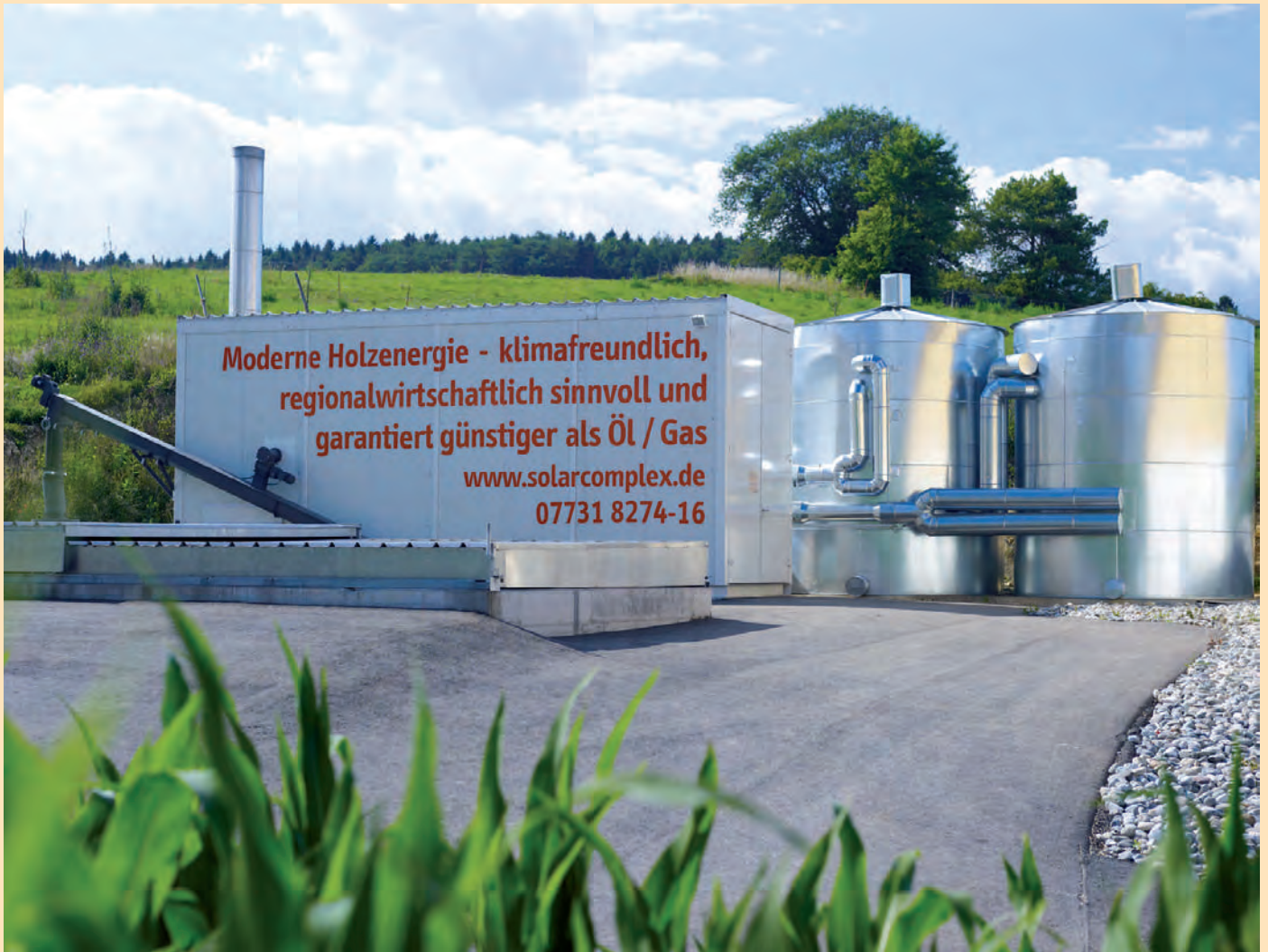
Bioenergiehof Mauenheim - 1 MW Hackschnitzelheizung im Container
