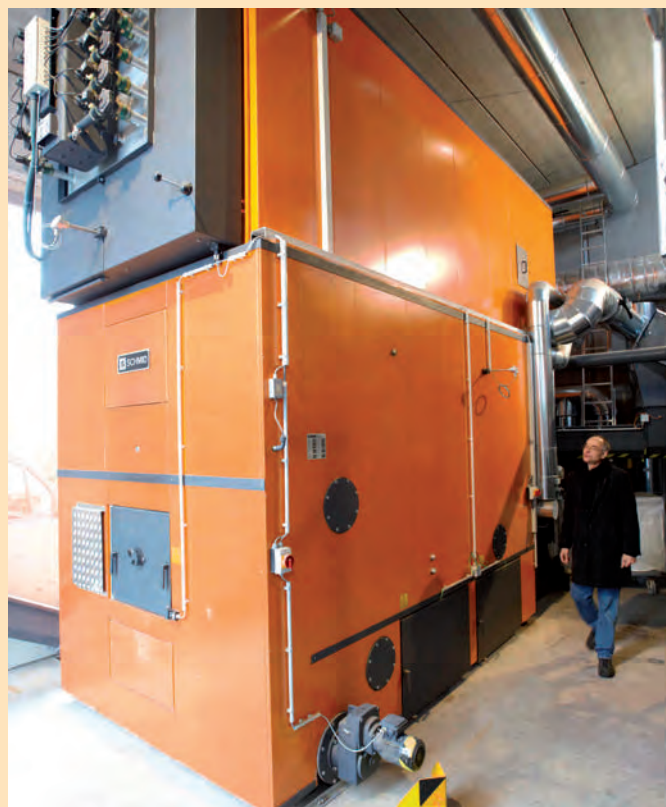
Heizzentrale Randegg, Hackschnitzelkessel mit 2 MW Leistung
